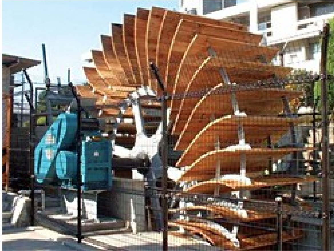
山梨県家中川(かちゅうがわ)小水力市民発電所(最大出力 20kW) http://www.enecho.meti.go.jp/saiene/renewable/water/index.html
