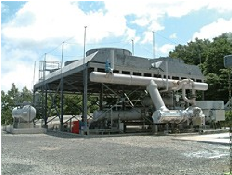
バイナリー発電設備2,000kW
