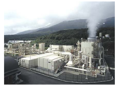
八丈島地熱発電所
